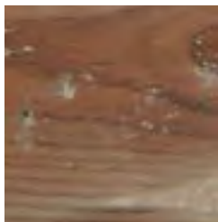
Surface mould/Moho superficial/ Moisissures superficielles/ Oberflächlicher Moder/Muf fa su- perficiale/Oppervlakte-schimmel/ Bolor superficial
