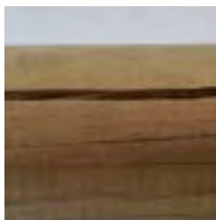
Cracks/Grietas/Fente/Risse/ Crepe/ Barsten/Fendas
